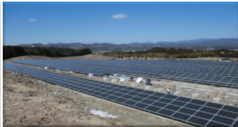
项目地：日本福冈 规模：30MWp
