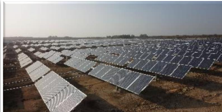
项目地：希腊*纳乌萨 规模：8MWp
